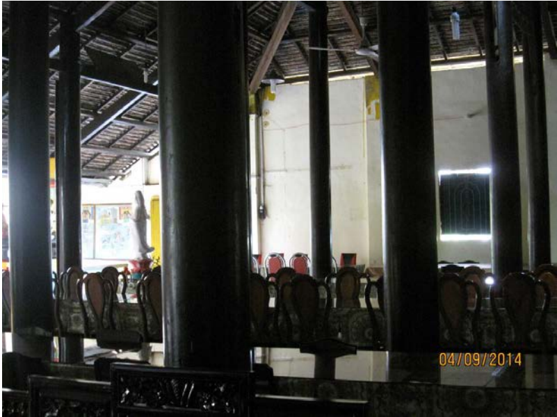
Nhà Trai đường với các hàng cột gỗ và các bộ trường kỷ bằng danh mộc
